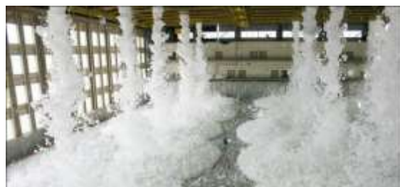
Рис. 13.2.3. Автоматичні стаціонарні установки пожежогасіння
